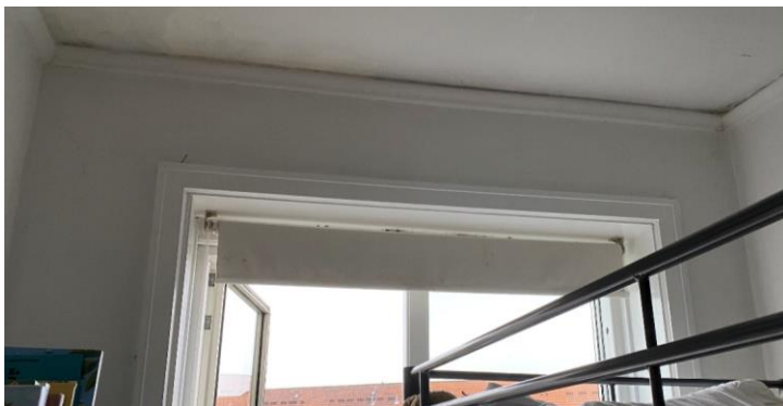
Værelse mod gård, fugt i vindueslysning
