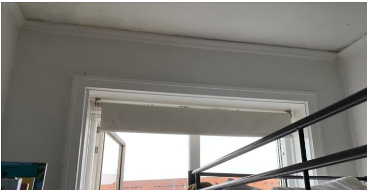
Værelse mod gård, fugt i vindueslysning
