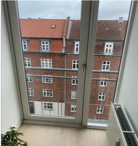
Der ses mindre fugtskade på gulv foran dør.
