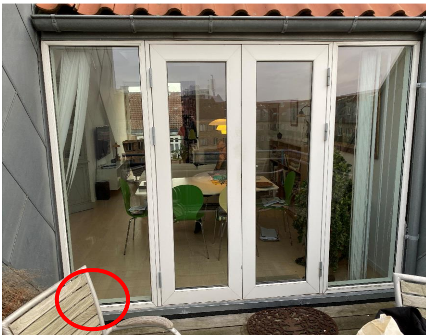
Tagaltan. Udvendig mistænkelig fuge og indvendig måles fugt.
