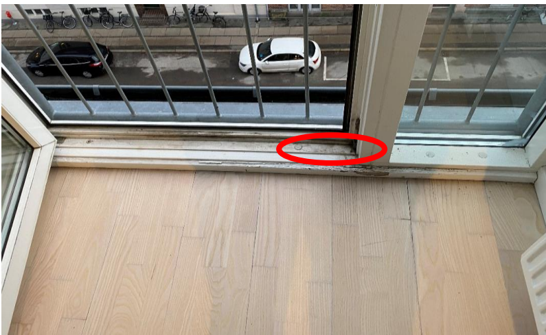
Der mangler ca. 150 mm fuge under altandør. Evt. er der tidligere udtaget fugeprøve, som aldrig er blevet udbedret.
