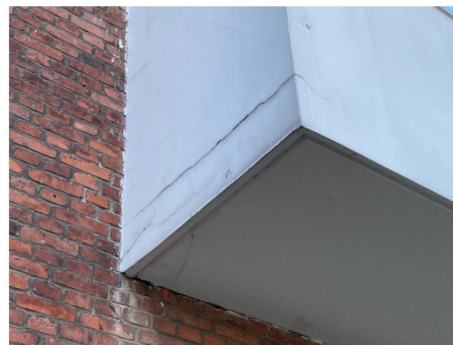
Revnedannelse i karnapbund
