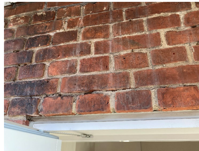
Revner over altandør
